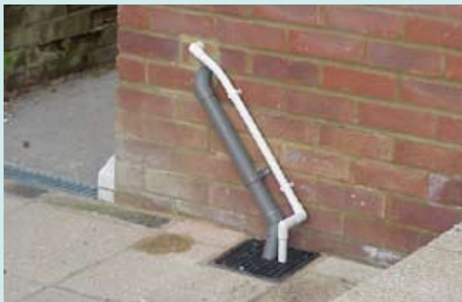
A condensate drain
